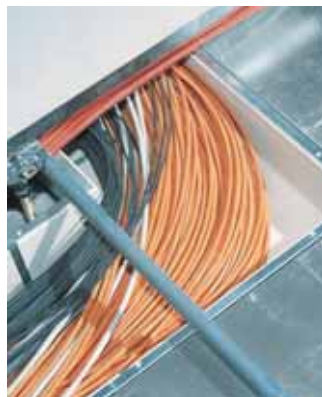
Durch die eingeprägte Gewinde ist die Installation für Wartungsarbeiten oder Erweiterungen jederzeit leicht zugänglich.
