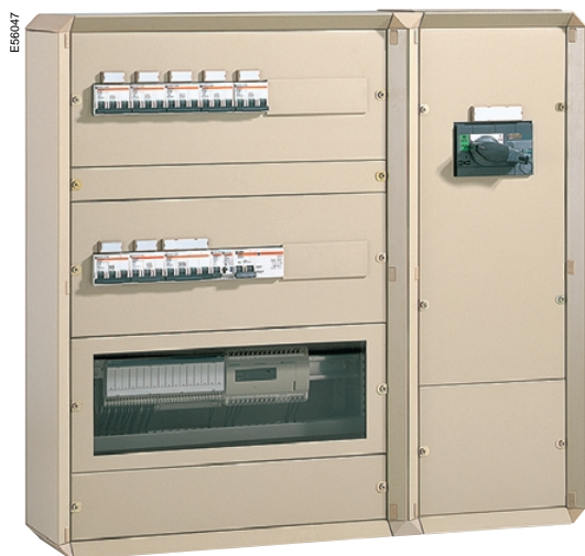
Вводной выключатель в силовом распределительном щите Prisma
